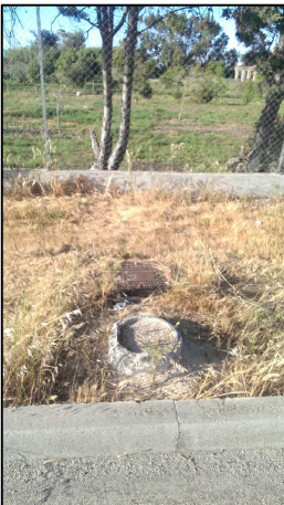
Pozzetto rete ENEL
