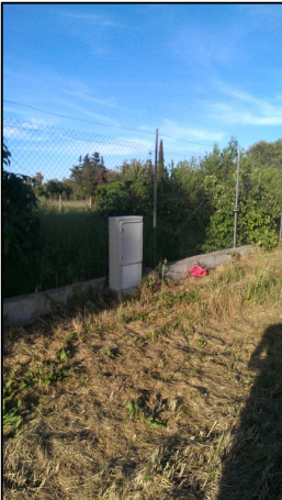
Armadietto stradale di derivazione ENEL
