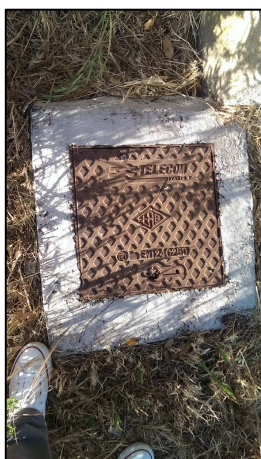
Pozzetto rete telecomunicazioni
