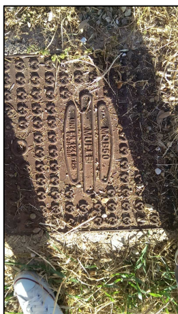
Pozzetto rete ENEL
