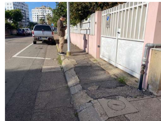
Marciaiede ovest tratto finale, sconnessioni
