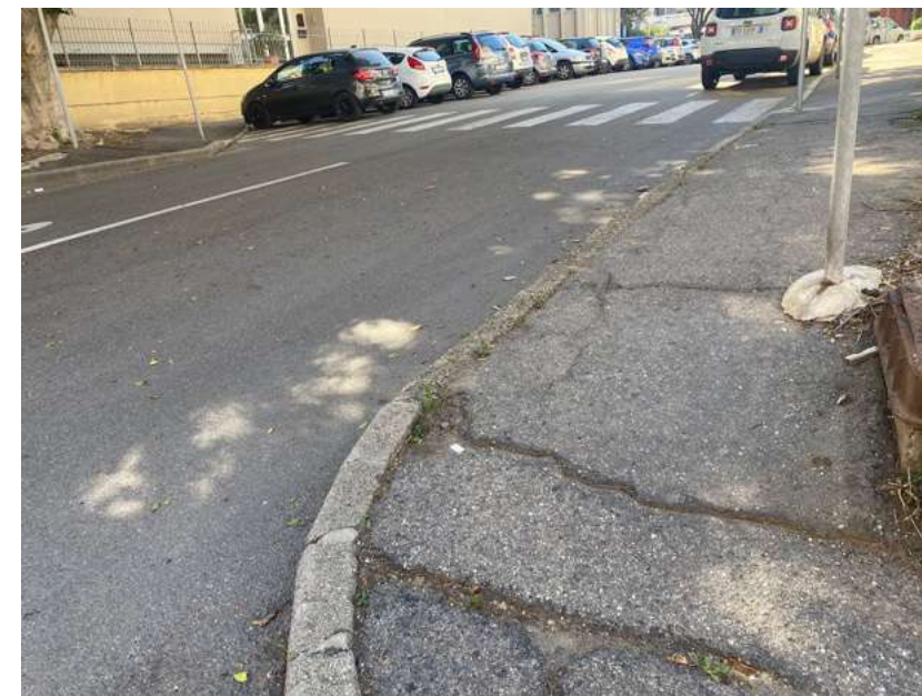
Incrocio via C. Mastino, sconnessioni e insicurezza
