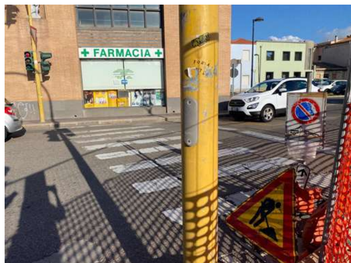
Incrocio Piazza Mariano- Via Mariano IV- Via Ricovero, assenza raccordi e insicurezza per assenza chiamata e cicalino impianto semaforico
