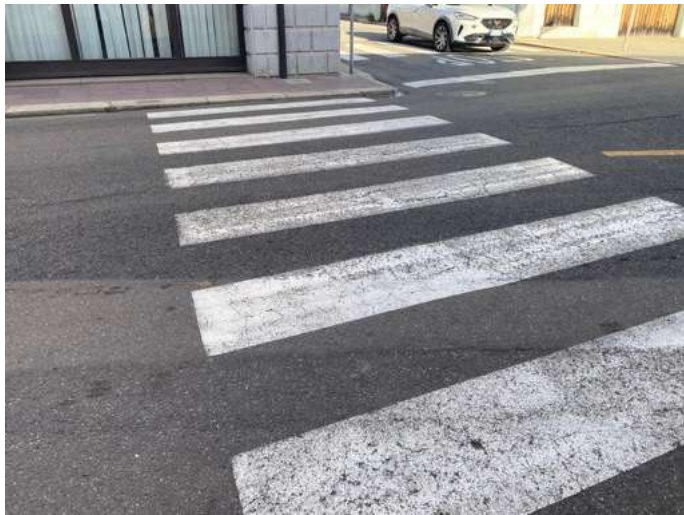
Attraversamento fine Piazza Mariano- inizio Via Vittorio Ven., assenza raccordi gradino h 4 cm
