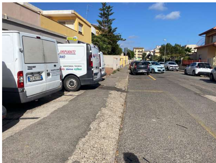
Presso num. civico 21 (Poste), sconnessioni del marciapiede e presenza parcheggi che restringono il passaggio
