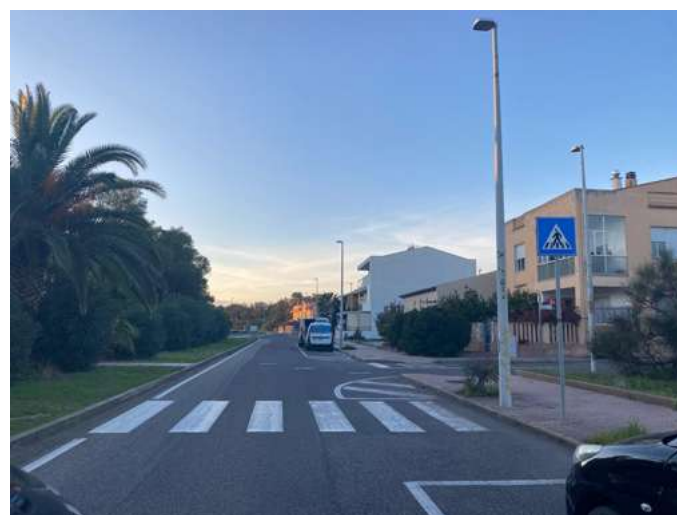
Attraversamento incrocio Via Livorno, assenza continuità percorso pedonale (nell'isola salvagente) e assenza raccordi
