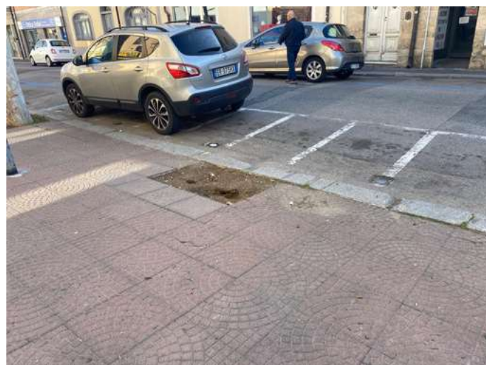
Via Mazzini marciapiede lato nord, assenza albero e segnaletica per sconnessioni
