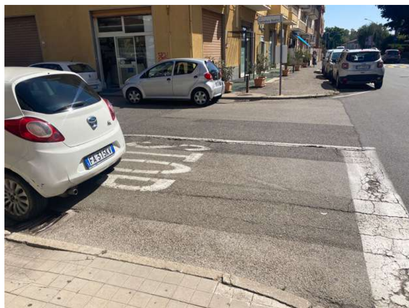
Incrocio via Baldino, assenza continuità
