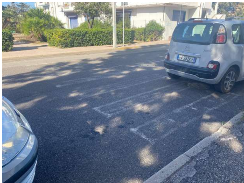
Incrocio con via Mattei, assenza attraversamento pedonale e sconnessione tappeto usura asfalto
