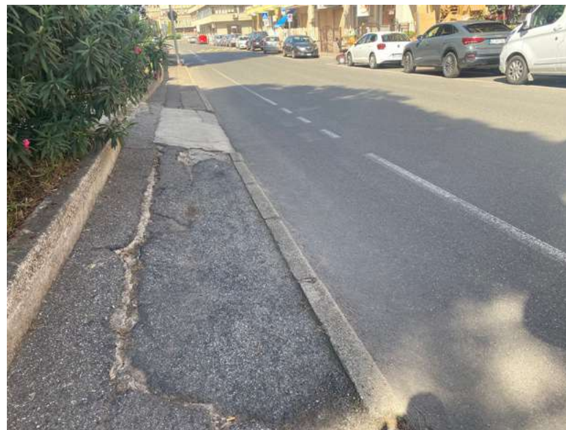
Marciapiede ovest, sconnessioni del tappeto usura
