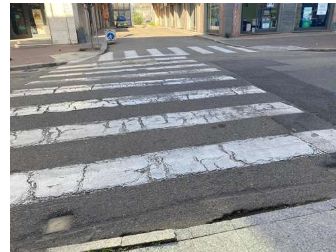
Attraversamento fronte ex mercato, sconnessioni e insicurezza
