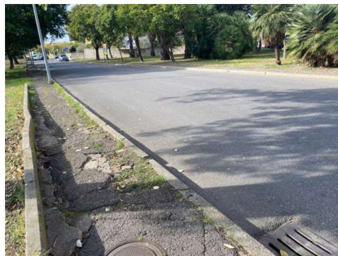
Marciaiede vicolo Gennargentu, sconnessioni e assenza continuità pedonale
