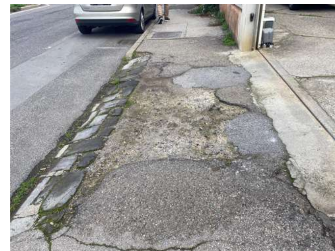
Marciaiede est da vicolo Gennargentu a Via Monte Gonare, sconnessioni
