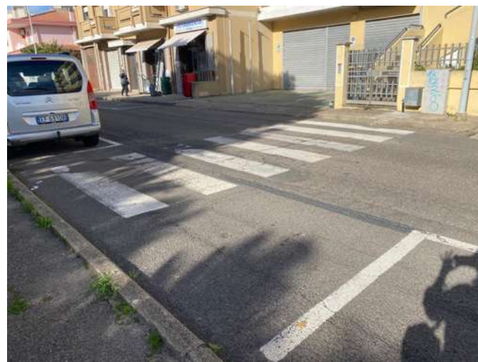
Attraversamento dopo vicolo Gennargentu, assenza raccordi e sconnessioni
