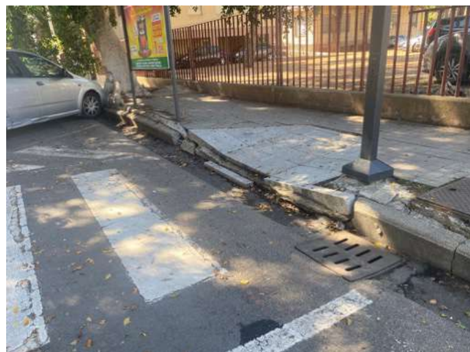
Attraversamento pedonale via d'Annunzio, assenza raccordi e insicurezza
