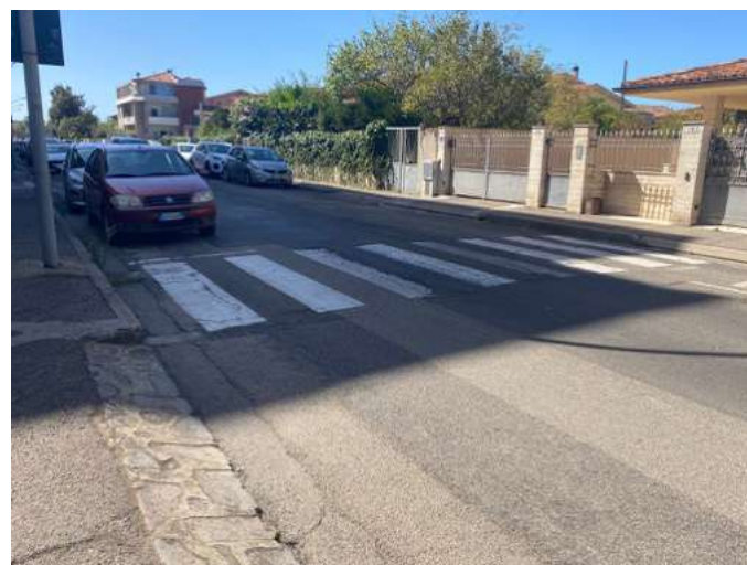
Attraversamenti pedonali lungo via Carpaccio, insicurezza per assenza raccordi
