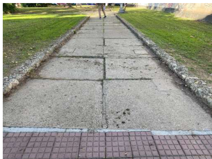
Giardini Via Bellini, sconnessioni
