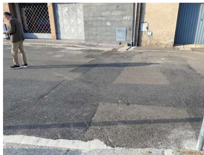
Incrocio Via Bosa, assenza continuità pedonale
