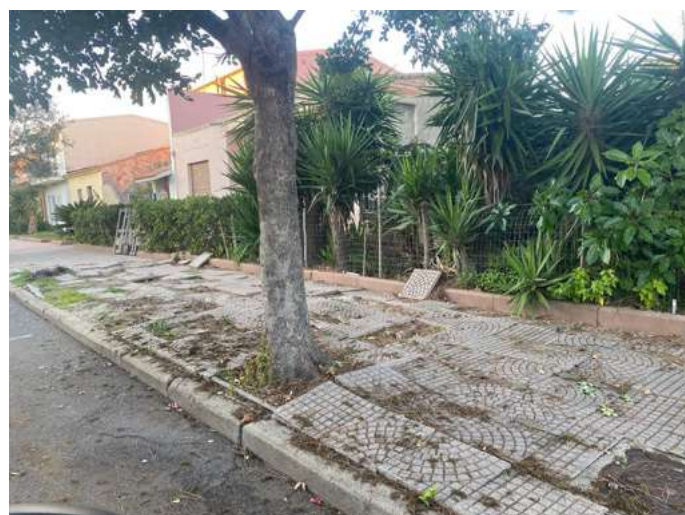
Marciapiede lato nord dopo Via Capo Teulada, pavimentazione sconnessa e a tratti assente
