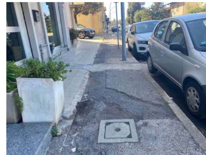
Marcia piede lato sud, sconnessioni
