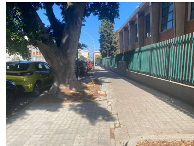
Viale Diaz da via XX Settembre a via D'Annunzio, sconnessioni puntuale del tappeto usura asfalto
