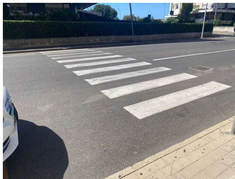
Attraversamento pedonale via Mattei, insicurezza per assenza raccordo
