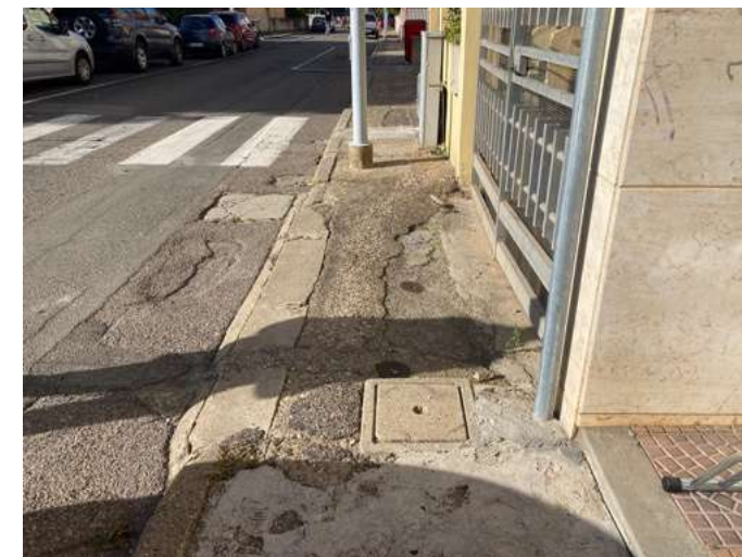
Marciaiede ovest dopo Via Limbara, pendenza e sconnessioni
